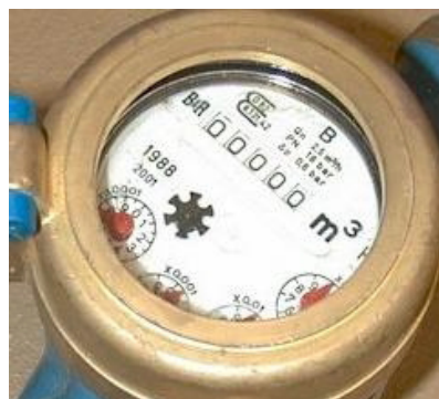
Der Wasserzähler mit dem Anlaufstern: Wenn er sich dreht, ist das ein erstes Anzeichen für verdeckten Wasserverbrauch
